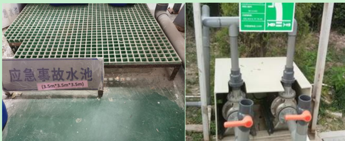
图 3.2-1 事故应急池及生活污水排口阀门
